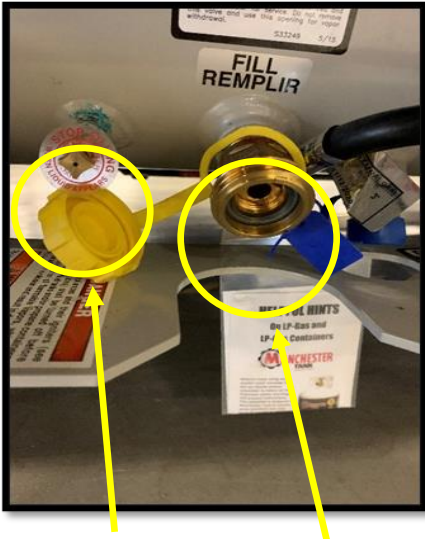
Vanne de purge de propane (à gauche) et vanne de remplissage (à droite)
